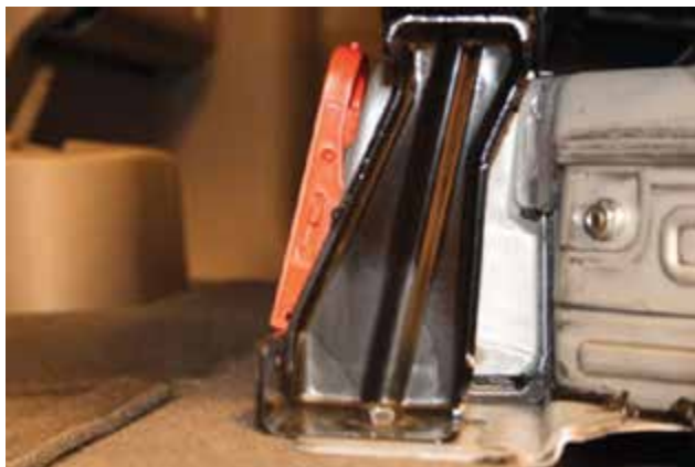
Рисунок 27-13: Высоковольтный сервисный размыкатель расположен возле высоковольтной батареи; источник: Delmar/Cengage Learning
