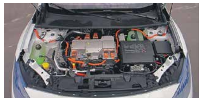
Рисунок 27-9: Высоковольтные кабельные линии, штекерные разъемы и зажимы HEVs имеют оранжевый цвет, а все компоненты, работающие под высоким напряжением, помечены знаком «Высокое напряжение»; источник: auto.ru.msn.com
